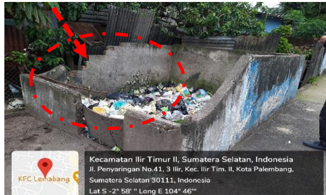
Gambar 4. Kerusakan di bak TPS Beton
