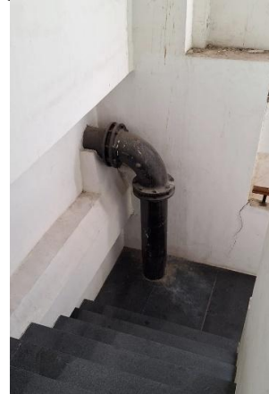
Gambar 6 Pipa Air Sumber : Dokumentasi Pribadi
